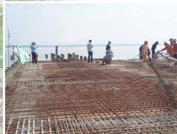
Ngày 16/12/2014 chính thức đổ sàn bê tông cầu cảng số 1 - dự án Cảng Long An.
